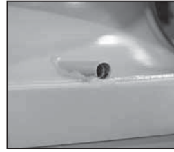
Fan Drain Connection
