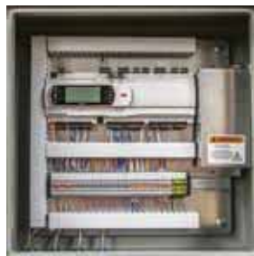
2 VGN Controller Box
